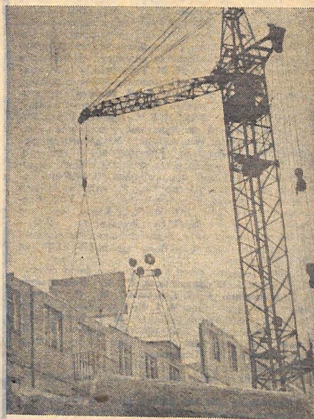
По Ровенському проспекту, що в обласному центрі, комплексна бригада з тресту «Кіровоградпромбуд», яку очолює Василь Каменний, веде монтаж вже третього крупнопанельного вісімдесятиквартирного житлового будинку.
