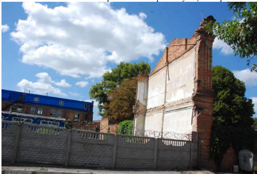
Від двоповерхового будинку дореволюційної побудови на розі з вулицею Тарковського залишилася стіна
